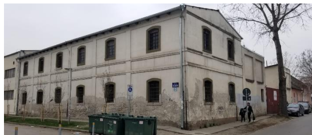
Slika 2. degradacija fasade starog dela
