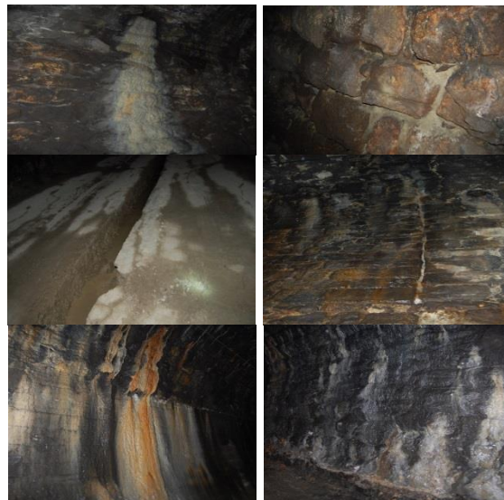
Slika 7: Karakteristična oštećenja kamene obloge i podnožnog svoda
