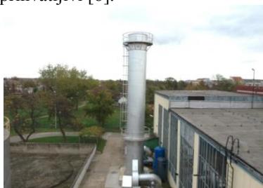
Slika 1. Toplovodni kotlovi 1, 2 i 3 sa zajedničkim emiterom [8]
