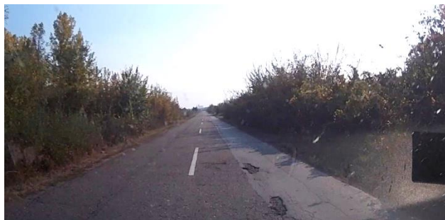
Slika 5: Predmetna deonica sa oštećenjima
