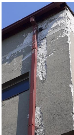
Слика 3. Ерозија фасаде услед цурења воде
