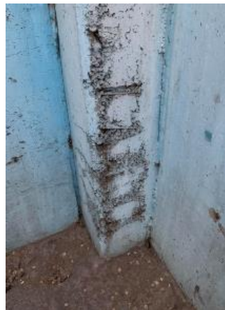
Slika 4. Segregacija betona u stubu
