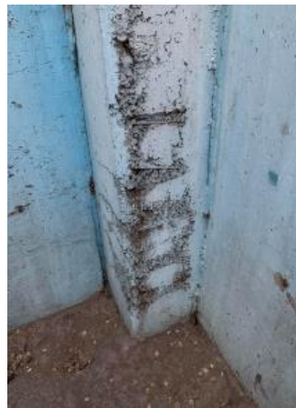
Slika 4. Segregacija betona u stubu
