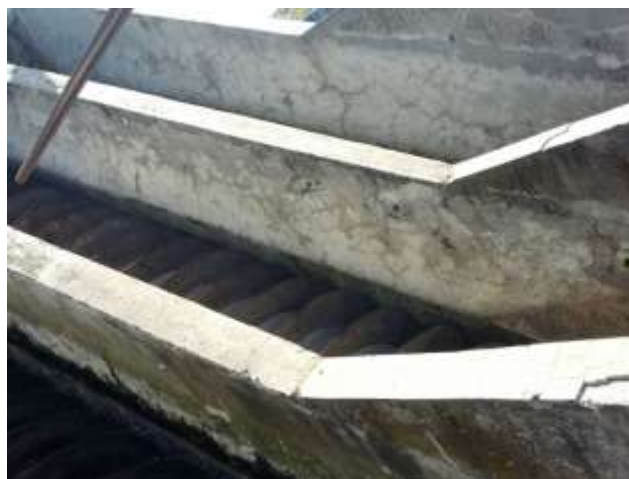
Slika 1. Oštećenja zidova crpnih pumpi
