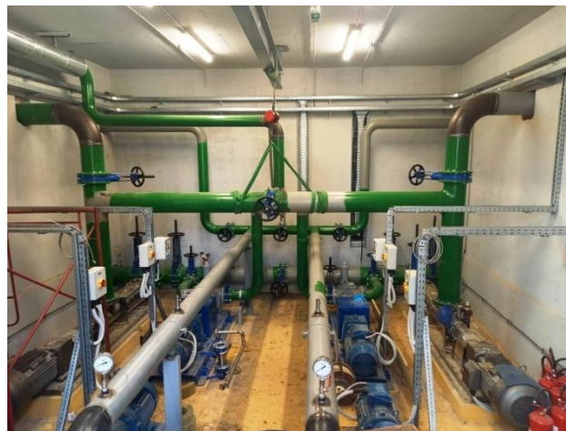
Slika 1. Prikaz pumpne stanice
