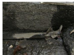
Слика 4. Оштећење заштитне гуме код подужне спојнице
