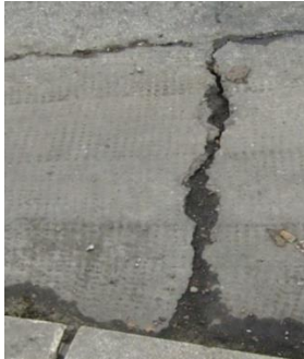
Слика 7. Пукотина бетонске плоче
