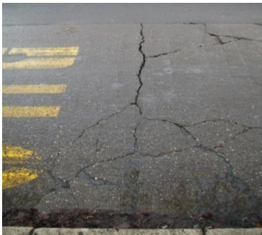
Слика 8. Мрежасте пукотине
