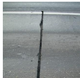
Слика 5. Оштећење и круњење бетона код попречних спојница
