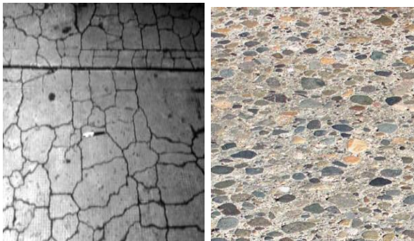
Слика 2. Мрежасте пукотине и углачан агрегат [1]
