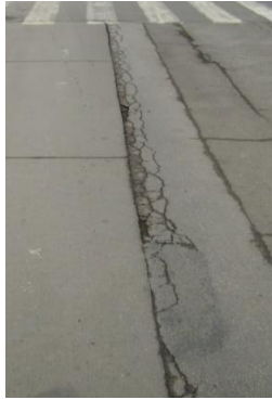
Слика 6. Круњење бетонске плоче у подужном правцу
