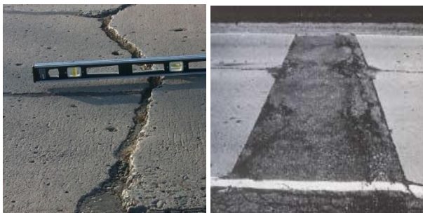
Слика 3. Слегање на попречној пукотини и закрпа [1]
