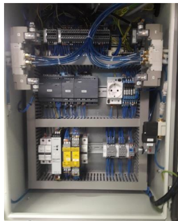
Slika 6. Fizička realizacija upravljačkog ormara
