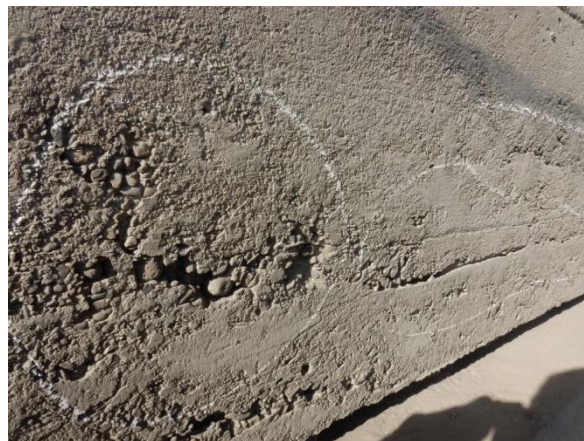
Slika 8. Veće betonsko gnijezdo na zidnom platnu
