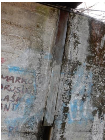
Slika 9. Oštećena olučna instalacija, slivanje vode, biološko rastinje
