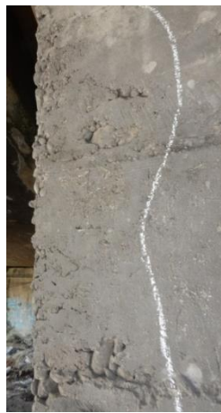
Slika 10. Betonsko gnijezdo na AB platnu
