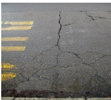
Слика 8. Мрежасте пукотине
