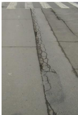
Слика 6. Круњење бетонске плоче у подужном правцу
