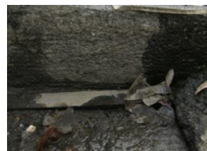
Слика 4. Оштећење заштитне гуме код подужне спојнице
