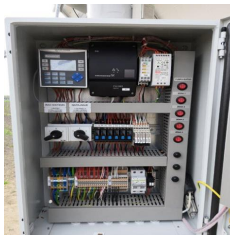
Slika 8. Upravljački orman sistema za navodnjavanje
