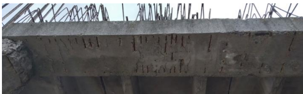
Slika 7 – Opšta korozijska uzengija sa bubrenjem, ljuskanjem i otpadanjem zaštitnog sloja betona, lokalno jaka korozijska uzengija grede, biološka korozijska betona na bočnoj površini grede
