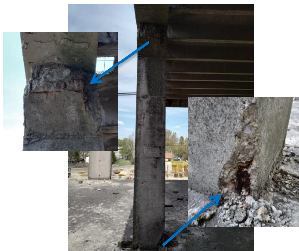
Slika 6 – Korozijska horizontalna i vertikalna armatura, praćena pucanjem, odvajanjem i otpadanjem zaštitnog sloja betona na čeonj strani kratkog elementa; korozijska glavna armatura, trošan beton u uglovima donjeg dela stuba
