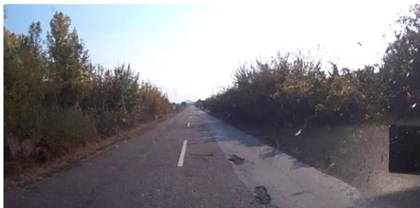
Slika 5: Predmetna deonica sa oštećenjima
