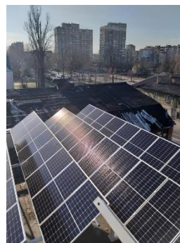
Slika 6: Fotonaponska elektrana montirana na objekat Integrisane fotonaponske elektrane su najsavremeniji način korišćenja fotonaponskih panela na maloj skali. Za razliku od elektrana koje se pomoću konstrukcije montiraju na tlo, ravan krov i kosi krov, integrisane elektrane su sastavni deo objekta i kao takve se instaliraju u toku izgradnje ili prilikom rekonstrukcije objekta. Date tehnologije su trenutno najmanje razvijene te su samim tim i najmanje zastupljen tip fotonaponskih elektrana.
