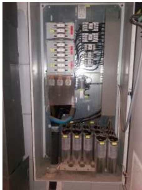
Slika 5 - Ugrađene kondenzatorske baterije i kondenzatorski kontaktori
