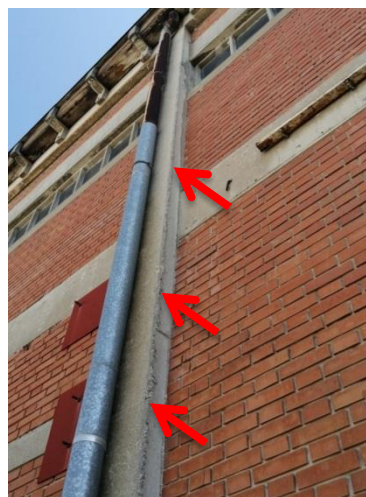
Slika 2 – Vertikalna suva linijska segregacija na AB stubu
