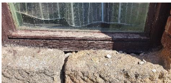
Slika 4. Izgled oštećenog prozora usled neodržavanja
