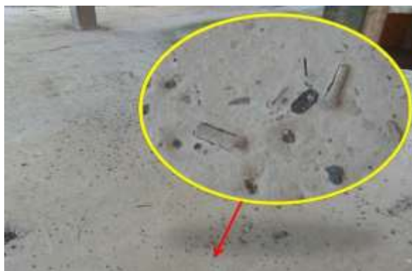
Slika 8. Rupičasta površina betona posledica korištenja zaprljanog agregata
