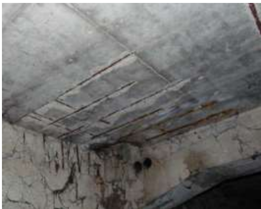
Slika 7. Korozija armature donje površine ploče iznad podruma
