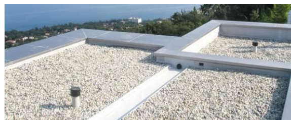
Slika 2. Neprohodna krovna terasa
