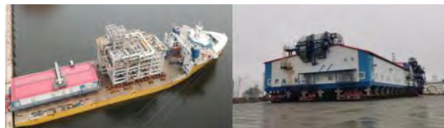
СЛИКА 4 – Central control building/electrical substation
