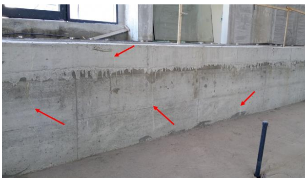
Slika 7. Prsline u zidovima velikog bazena
