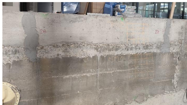
Slika 3. Loše izvedeni nastavci betoniranja
