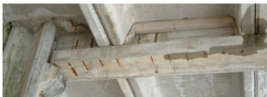
Слика 3. Дефект недовољне дебљине заштитног слоја бетона
