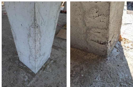
Слика 10. Дефекти на стубовима
