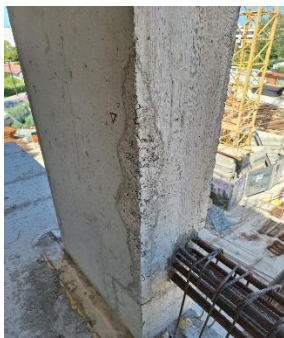
Слика 2. Сегрегација бетона
