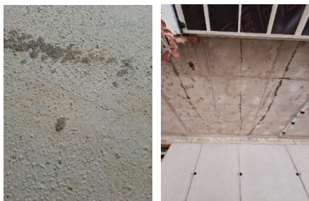
Слика 12. Оштећења на АБ плочама
