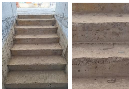
Слика 11. Дефекти на АБ степеништима
