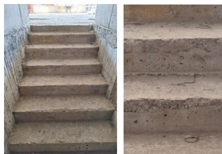
Слика 11. Дефекти на АБ степеништима
