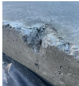
Слика 6. Механичка оштећења
