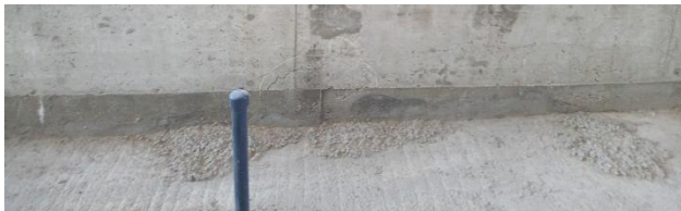
Slika 4. Ostaci betona nakon ugradnje
