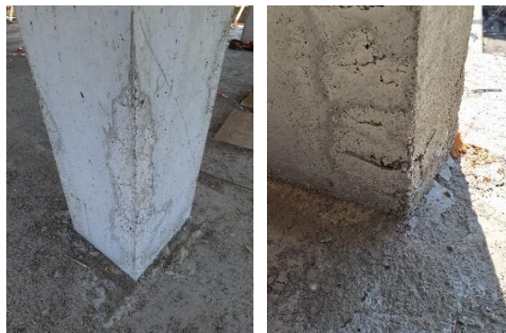
Слика 10. Дефекти на стубовима
