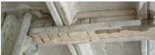
Слика 3. Дефект недовољне дебелине заштитног слоја бетона
