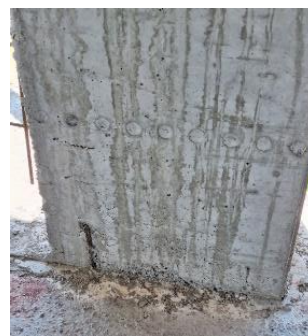
Слика 7. Мрље на бетону
