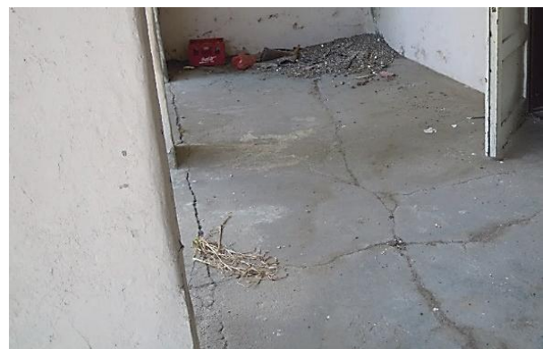
Слика 6. Оштећења подне плоче на улазу у објекат са источне стране, пукотине и прслине
