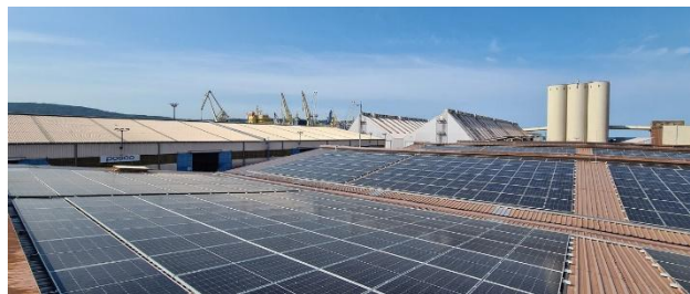
Слика 1. Соларна електрана на крову [1]
