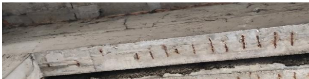
Слика 9. Недовољна дебелина заштитног слоја бетона, отпадање заштитног слоја бетона, видљиве кородирале узенгије
