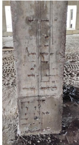
Слика 8. Мали заштитни слој бетона, видљиве кородирале узенгије, пуцање и отпадање заштитног слоја бетона
