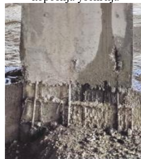
Слика 5. Неправилно постављена арматура у зони споја платна и темељне греде
