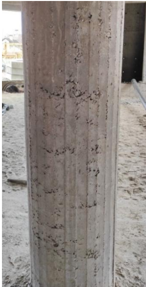
Слика 7. Изглед кружног монолитног стуба, порозан заштитни слој бетона
