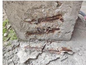
Слика 3. Пуцање и отпадање заштитног слоја бетона, јака корозија узенгија
