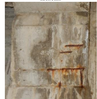
Слика 6. Корозија арматуре, пуцање и отпадање заштитног слоја бетона, кратки елемент
