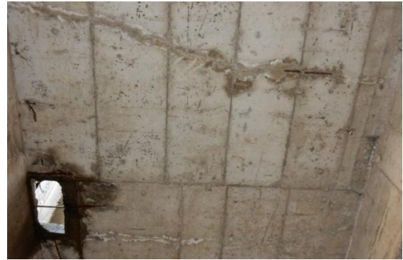
Слика 10. Попречна прслина на месту арматуре, корозија арматуре у зони отвора и попречне прслине
