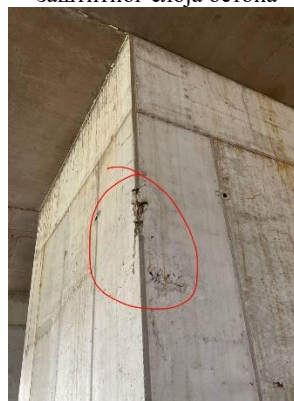
Слика 5. Одломљени део бетона
