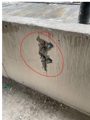
Слика 3. Пуцање и отпадање заштитног слоја бетона
