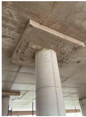
Слика 8. Мали заштитни слој бетона, пуцање и отпадање заштитног слоја бетона
