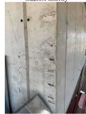
Слика 6. Отпадање заштитног слоја бетона
