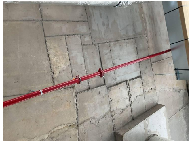
Слика 10. Трагови процуривања кроз оплату плоче
