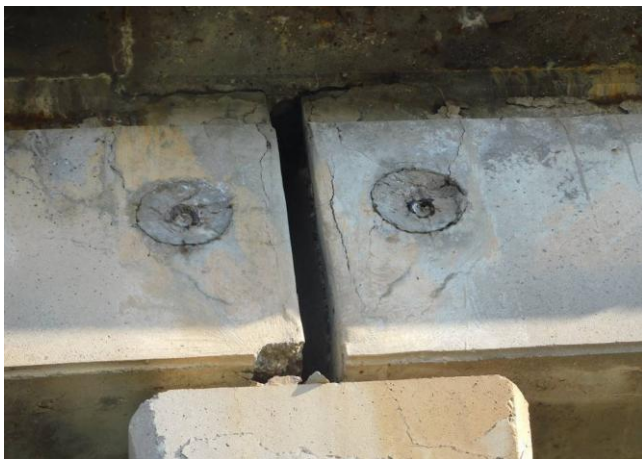
Слика 2. - Пуцање и отпадање заштитног слоја бетона
