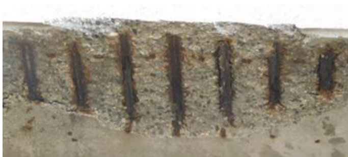
Слика 4. - Пуцање и отпадање заштитног слоја бетона
