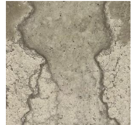
Слика 4. Површинско (плитко) бетонско гнездо и мрље од влаге
