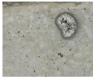
Слика 3. Бетонско гнездо и рупичаста површина на стубу
