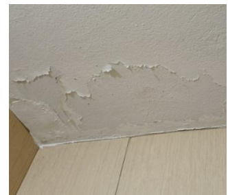
Слика 6. Појава влаге и љускање завршног слоја на плафону у купатилу
