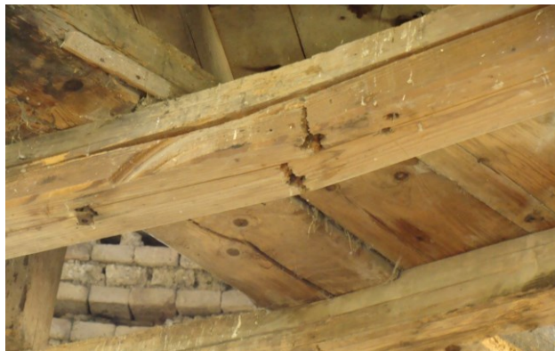
Slika 6: Pukotine na sredini tavanjače
