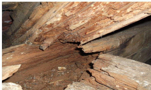
Slika 8. Oštećenje drvenih elemenata krovne konstrukcije
