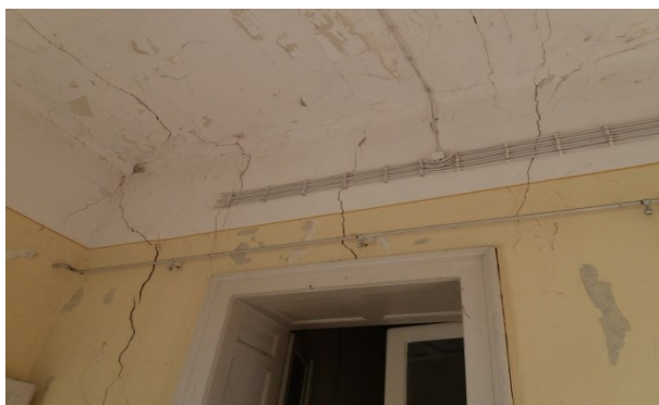
Slika 6. Pukotine iznad vrata na spratu objekta
