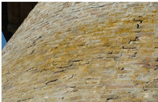
Slika 5: Oštećenja usled vlage od atmosferskih padavina
