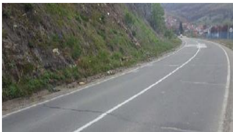
Слика 2: Попречне пукотине на деоници
