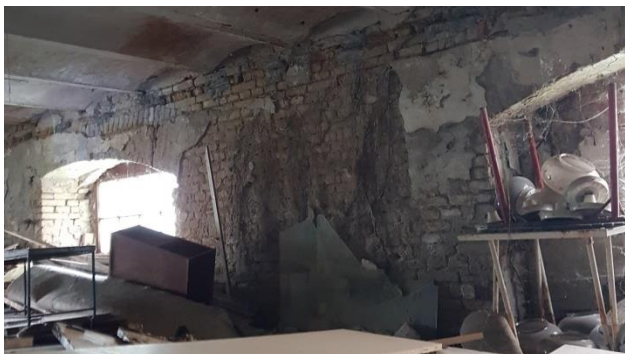
Slika 4. Biološko rastinje u zidu [4]
