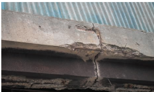
Slika 5. Pukotina na AB gredi, mala debljina zaštitnog sloja betona
