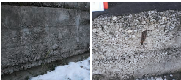
Слика 4. Бетонска гнезда, сегрегација, крупна зрна агрегата, лабава зрна агрегата, недостатак цементне пасте, корозија арматуре.
