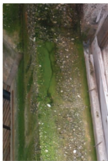
Slika 4. Biološka korozija, slivanje vode, erozija betona AB stuba
