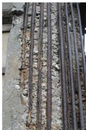
Slika 3. Korozija armature, mala debljina zaštitnog sloja betona, nepravilan raspored armature u stubu
