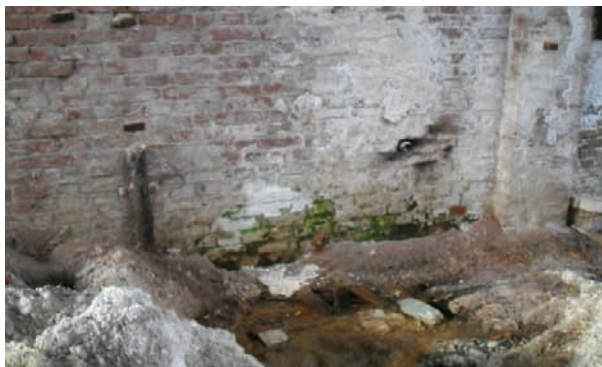
Slika 6. Eflorescencija soli na zidu
