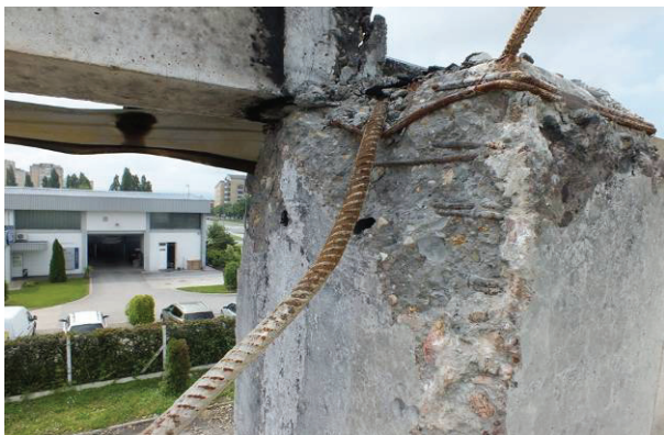
Slika 4. – Drobljenje betona u zoni oslanjanja
