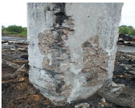
Slika 3. – Ljuskanje i otpadanje trošnog betona
