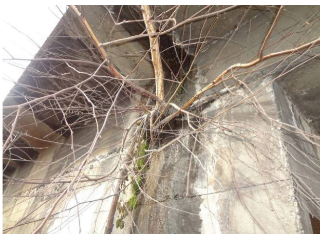
Slika 8- Biološko rastinje na spoju glavnog nosača sa potpornim zidom
