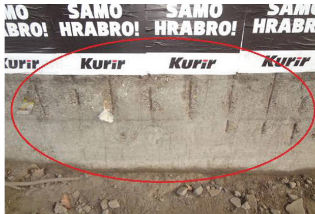
Slika 6- Mali zaštitni sloj betona zidnog nosača
