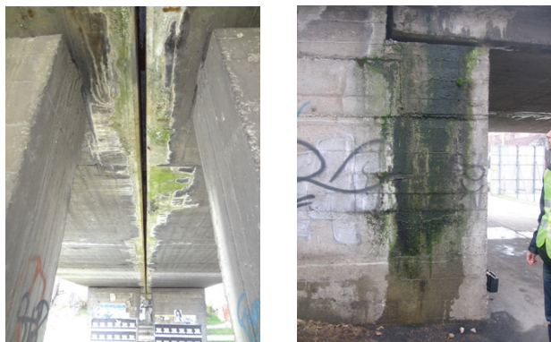
Slika 7- Prodor vode, mrlje na površini, mahovina, korozija armature na dilatacionim razdelnicama između glavnih nosača i na spoju sa potpornim zidovima
