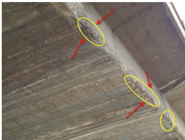
Slika 9- Korozija armature, bubrenje i izvijanje šipki i otpadanje betona donjih ivica glavnog nosača
