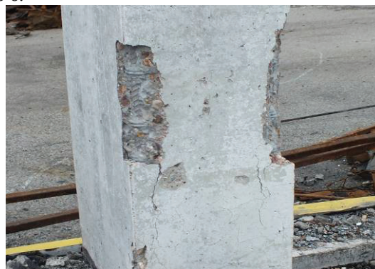
Slika 2. – Otpadanje betona duž ivica stuba
