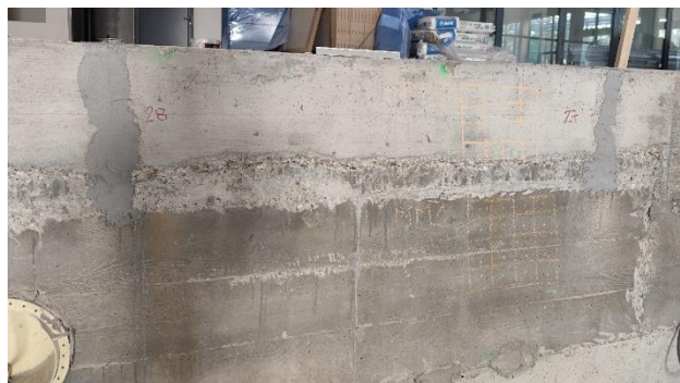
Slika 3. Loše izveden nastavak betoniranja
