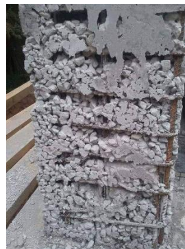
Слика 1. Бетонско гнездо
