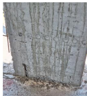
Слика 7. Мрље на бетону
