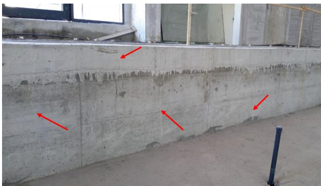
Slika 7. Prsline u zidovima velikog bazena
