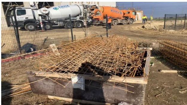
Slika 4. Oštaci čelika nastali usled izvođenja radova na armiranju
