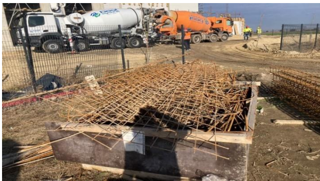
Slika 4. Ostaci čelika nastali usled izvođenja radova na armiranju
