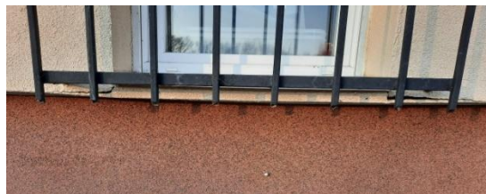
Слика 4. Пукотине и отпадање дела фасаде
