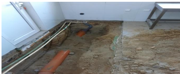
Слика 3. Локација оштећења водоводне цеви
