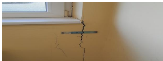
Слика 3. Индикатор прлина, северни зид објекта
