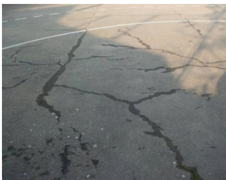
Слика 6-Пукотине и површинска ерозија
