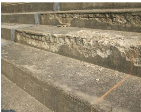
Слика 5 –Корозија арматуре и отпадање заштитног слоја
