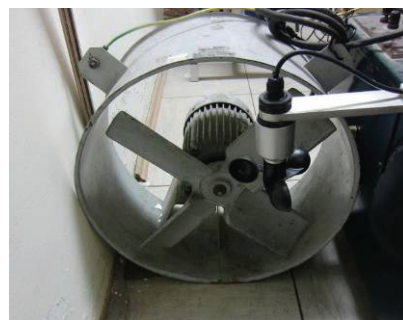
Slika 8. Senzor (anemometar) i aktuator (motor sa ventilatorom)
