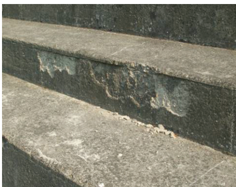
Слика 4 - Лоше изведен наставак бетонирања на споју плоче и ребра и отпао бетон последица подливане воде кроз прекид
