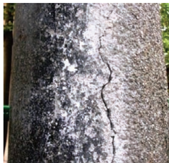
Слика 9. Пукотина кроз облогу стуба услед корозије.
