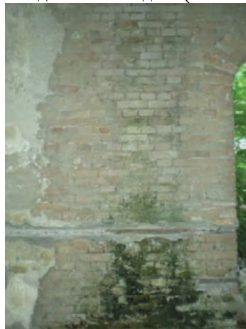
Слика 10. Отпадање малтера и биолошка корозија услед присуства капиларне влаге у зиду
