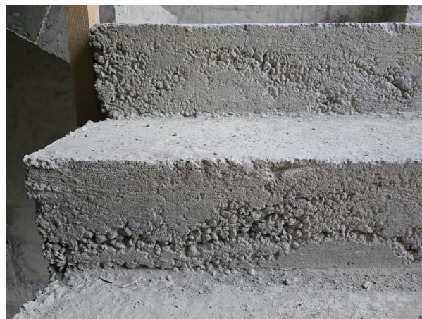
Слика 7. Дефекти на АБ степеништима
