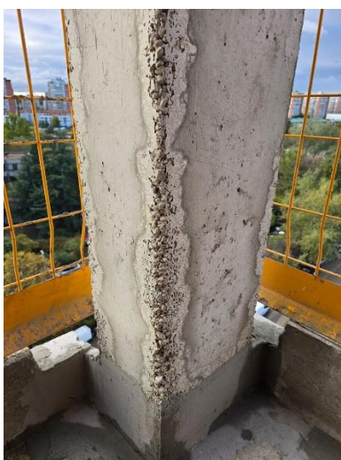
Слика 6. Дефекти на стубовима: изражена линијска сува сегрегација бетона
