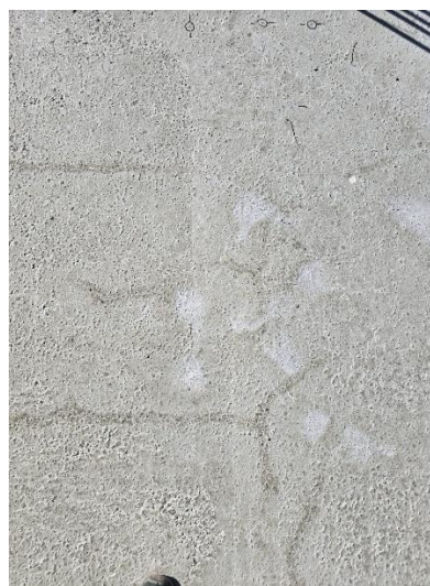
Слика 8. Оштећења на АБ плочама: прелине услед пластичног скупљања
