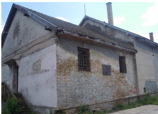
Слика 7. Оштећења на западној фасади, отпадање материјала - механичка оштећења, отпадање малтерске облоге, испирање малтерских спојница
