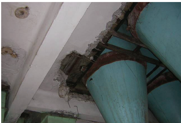
Slika 5. Grubo i nepravilno prošireni otvori u AB ploči
