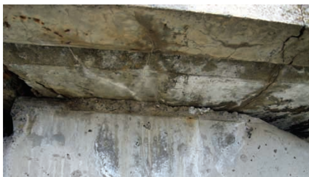
Слика 7. Пррлине и пукотине, отпадање ивице бетона, тачкаста корозија
