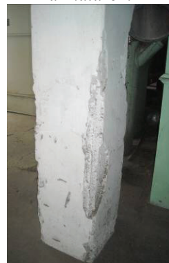
Slika 8. Odvaljene ivice stuba i otpali delovi maltera
