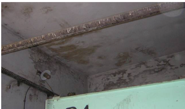
Slika 4. Tragovi prodiranja atmosferilija na donjoj površini krovne AB ploče i u uglu zidova
