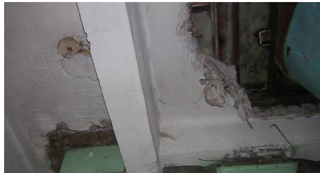
Slika 6. Grubo i nepravilno prošireni otvori u AB ploči
