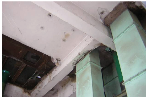
Slika 7. Lokalno oštećenje grede sa ogoljenom donjom armaturom
