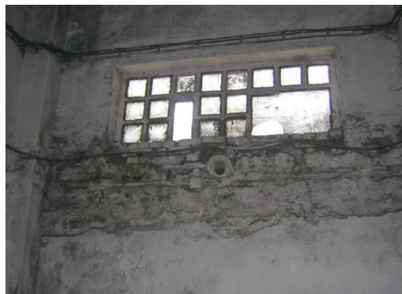
Slika 9. Karakteristična oštećenja zidanih zidova
