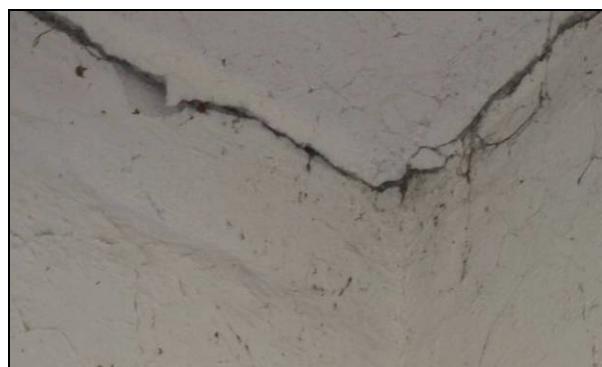
Slika 6. Pukotina na spoju zida i tavanice
