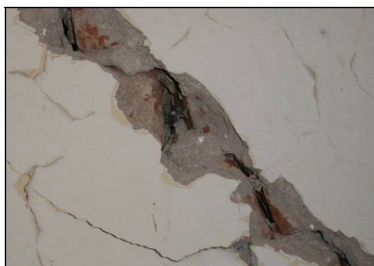
Slika 3. Pukotina u zidu koja prolazi i kroz spojnicu i opeku
