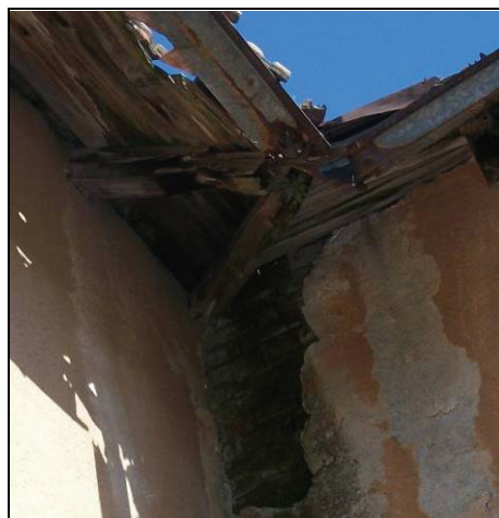
Slika 5. Oštećenja zidova zbog vlage od atmosferilija
