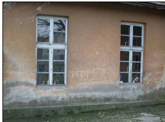
Slika 4. Oštećenja zidova zbog prodora vlage iz tla
