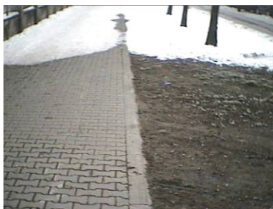
Slika 2: Prikaz lokacije na kojoj je uočeno curenje
