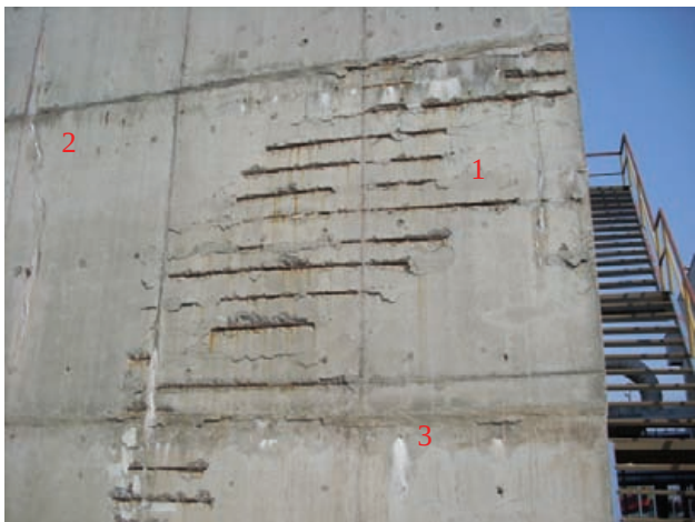
Slika 9. Ogoljene šipke armature (1); novonastale prsline (2) i ispiranje \text{Ca}(\text{OH})_2 (3) na zidu bazena
