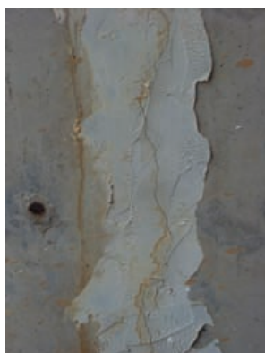
Sl. 6. Novonastala prsline na mestu injektiranja
