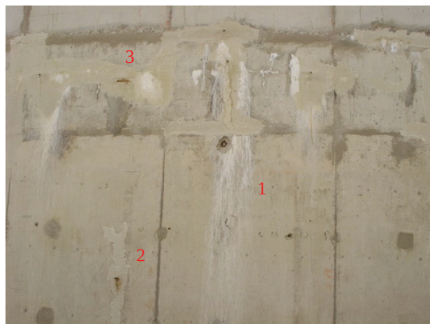
Slika 7. Ispiranje kalcijum-hidroksida (1); sanirane prsline (2) i popravke na mestu prekida i nastavka betoniranja (3) na pojasu segmenta 3
