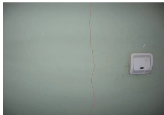
Slika 5: Vertikalna pukotina u zidu u osi B''/2-3, sprat 8
