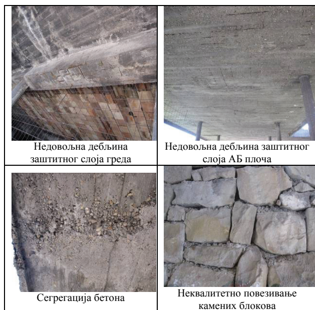
Слика 3.-видљиви дефекти
