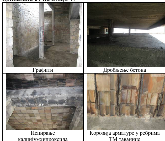
Слика 4.-видљива оштећења
