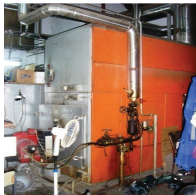
Slika 5. Izgled jednog kotla u okviru kotlarnice Hotela Aqvamarin
