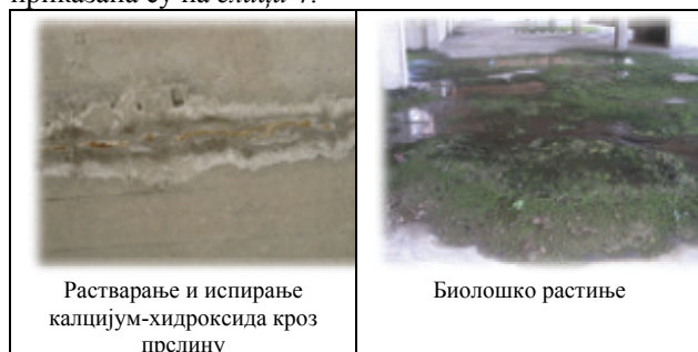
Слика 4. Видљива оштећења
