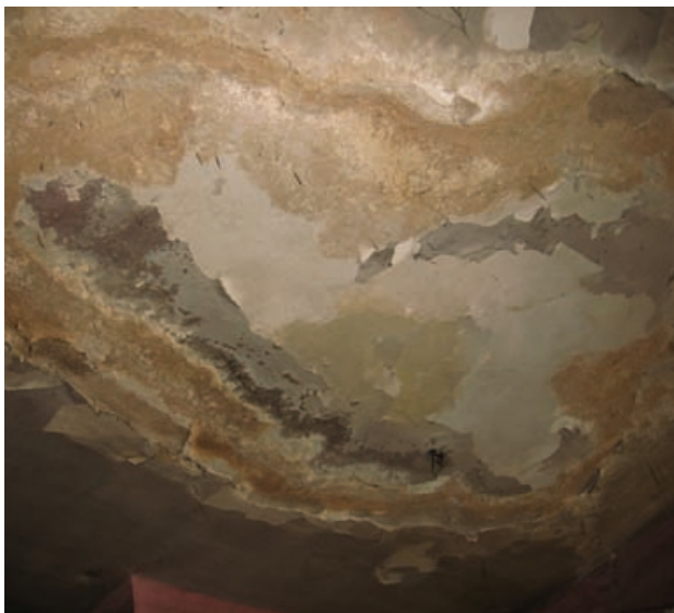
Slika 4. Otpadanje maltera i završnog premaza na plči B-B'/1-1' usled vlage
