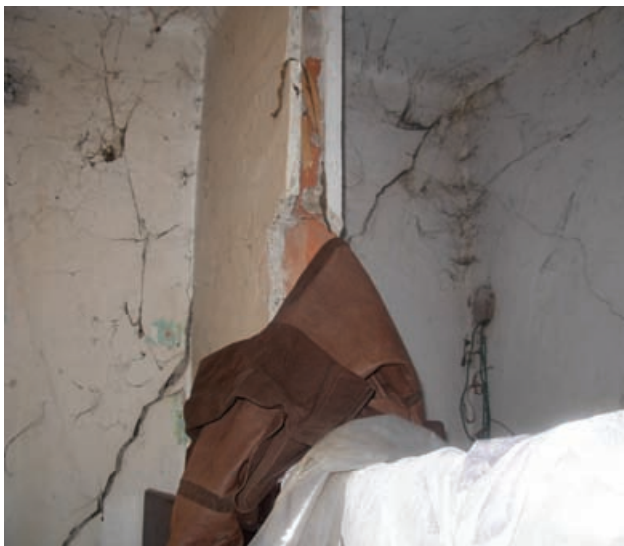
Slika 3. Kose pukotine u zidu 3/B-B' koje prolaze celom debljinom zida i kroz malter
