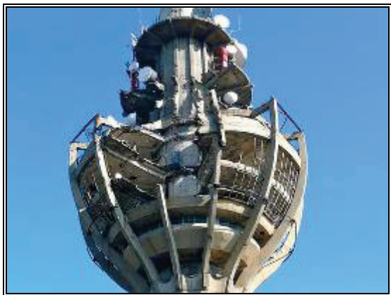
Sl.3. Oštećenja nastala na objektu 1999. godine
