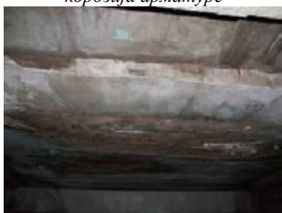
оштећења сипорекс плоче
