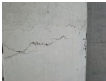
Slika 8. Raslojavanje na mestu prekida i nastavka betoniranja.
