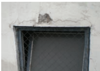
Slika 10. Pukotine oko otvora
