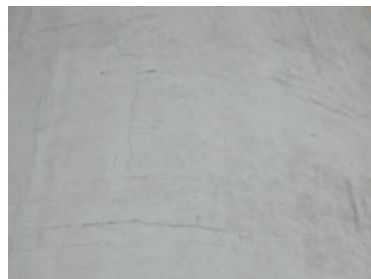
Slika 7. Poprečne (horizontalne) prsline
